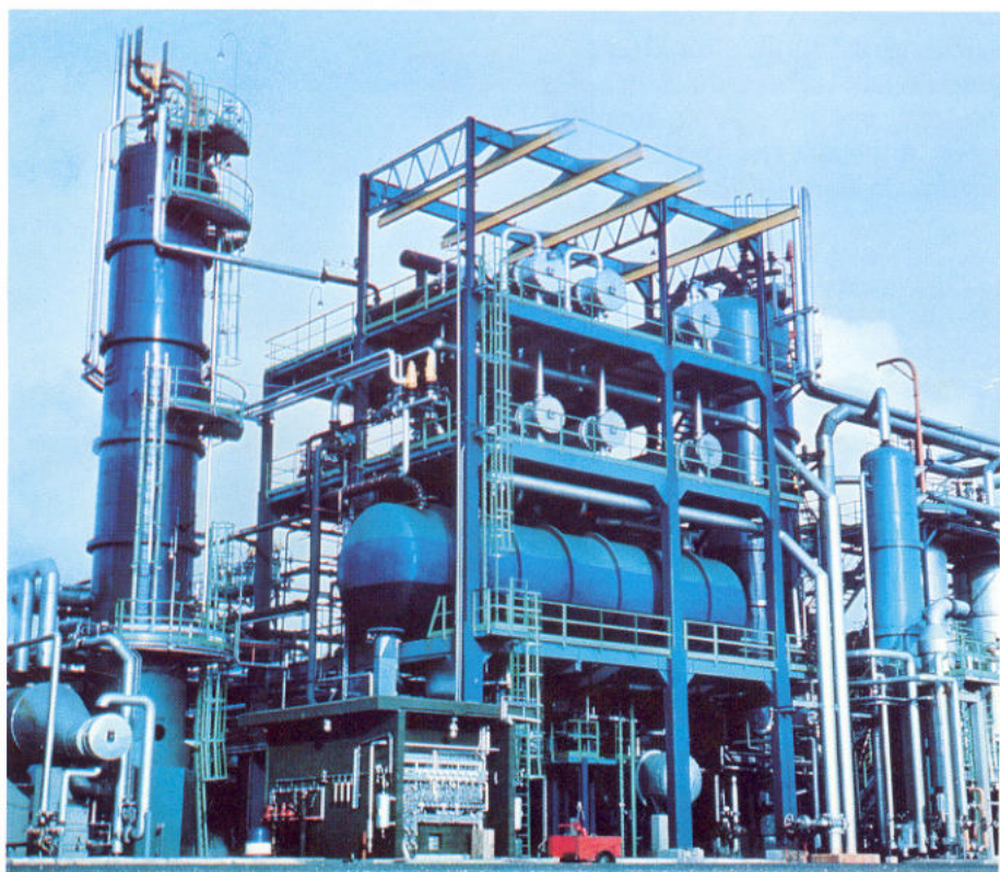
Unité de fabrication du Vistalon à l'usine SOCABU.
