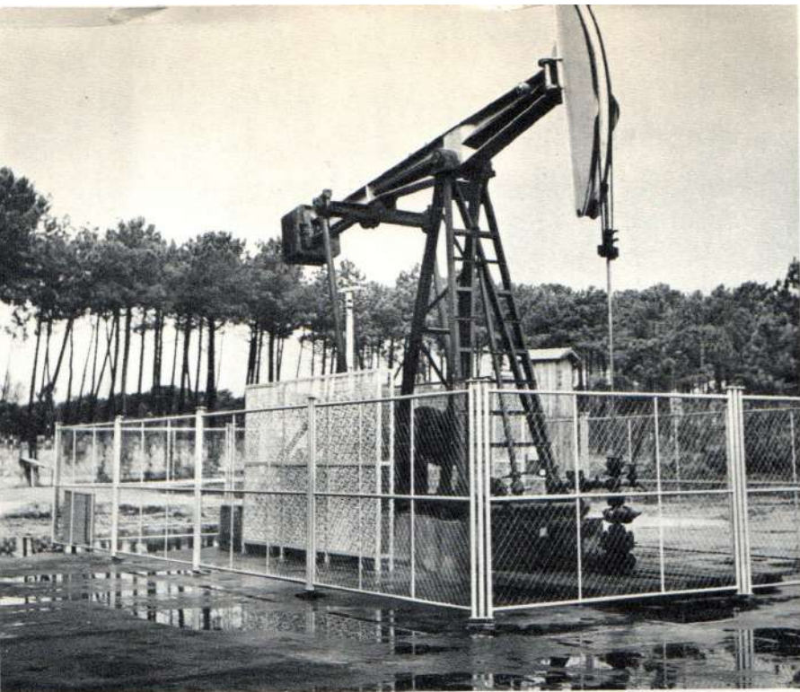
Certains puits, situés à la limite du gisement et pour cette raison faibles producteurs, ont été équipés d'une installation de pompage qui permet d'améliorer sensiblement leur rendement.
